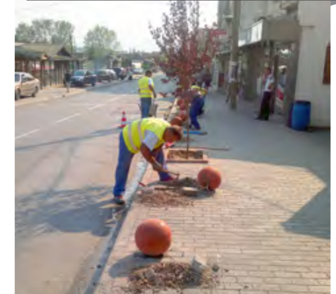
Placement of bollards to avoid irregular parking Vendosja e pengesave për të ndaluar parkimin e parregullt Postavljanje stubića kako bi se sprečilo nepropisno parkiranje
